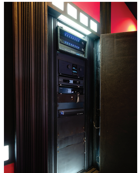
ผนังด้านข้างห้องทำเป็น rack ซ่อนไว้อยู่ภายใน
